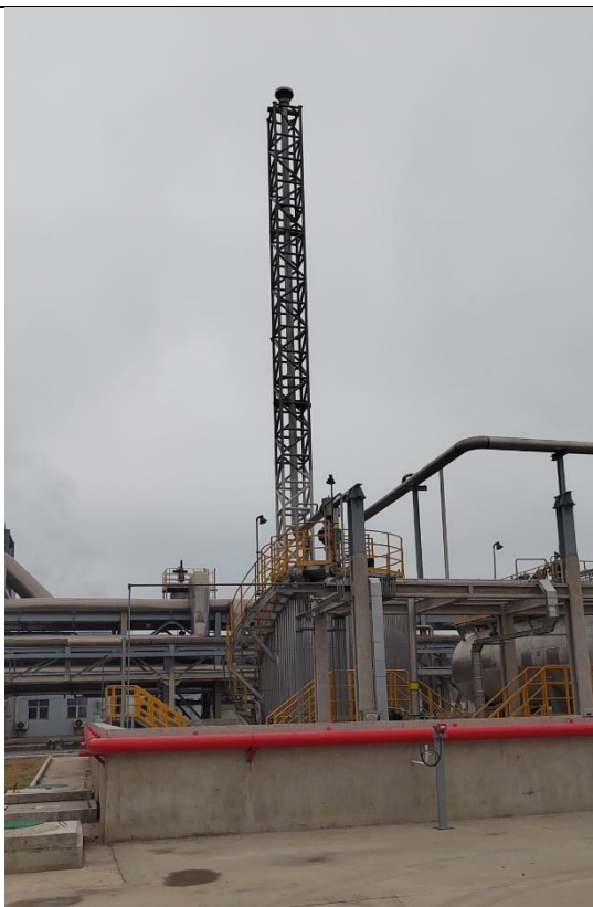
氨吸收罐呼吸阀 25m 高排放口
