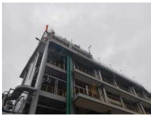
A11 GPPS/MS拆包箱废气排气筒
