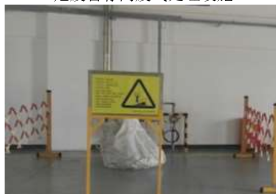
危废暂存间内部标牌
