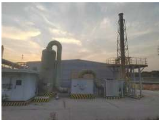
A9 危废库废气排气筒
