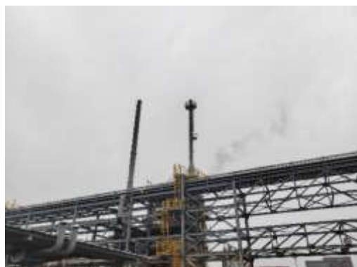
A1 氧化炉排气筒
