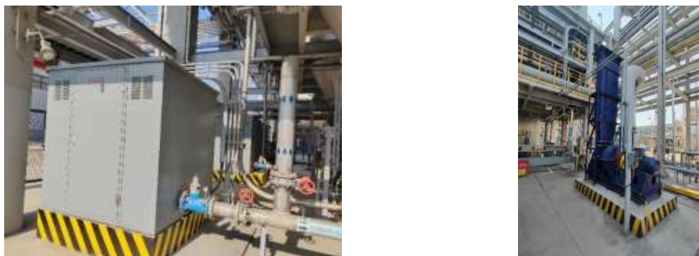
图 4.1.3-1 本项目噪声治理措施现场图
