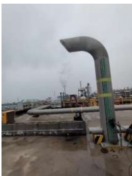
A4 干燥废气排气筒
