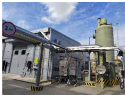
危废暂存间废气处理设施
